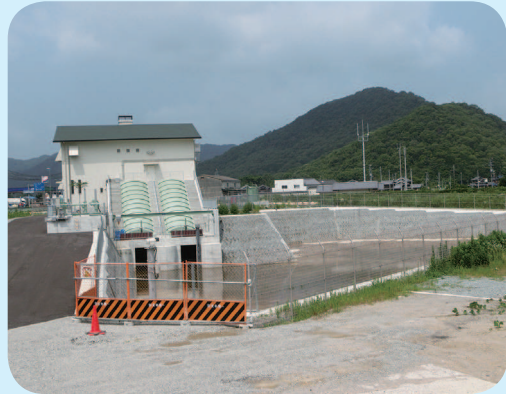
有年ポンプ場
