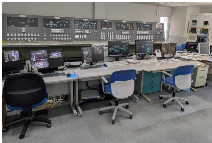
中央監視装置写真(現況)
