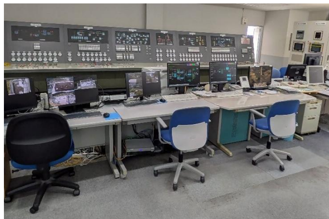
中央監視装置写真(現況)
