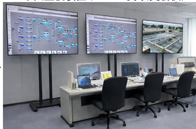
中央監視装置イメージ写真(更新後)
