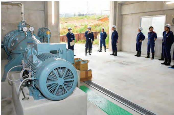
出水期を前に市内各所の状況を把握するため、水防本部構成員による巡察を行いました。 (5/21 福浦排水機場)
